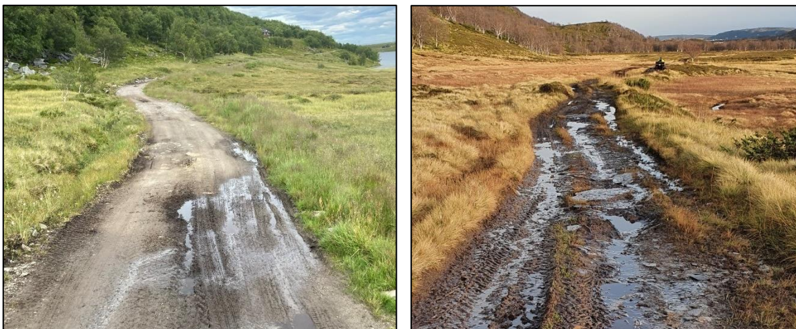
Figur 2-4. Vest for Strandvatnet går veien stedvis gjennom myrlendte områder, der veien har dårlig dreneringsevne. Foto: T.v. Sweco. T.h. Repvåg kraftlag AS.
