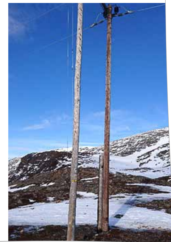
Stolpebrann ved Myrfjord. Punktet midlertidig utbedret
