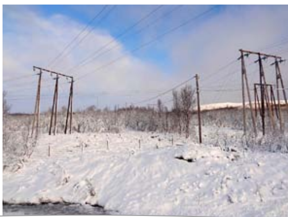
66 kV-linjene til Havøysund og Honningsvåg.
